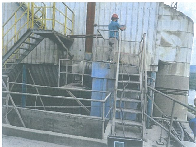
4#水泥立磨回料系统排放口 (DA043)
