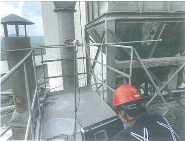
1#水泥原料仓顶排放口 (DA031)
