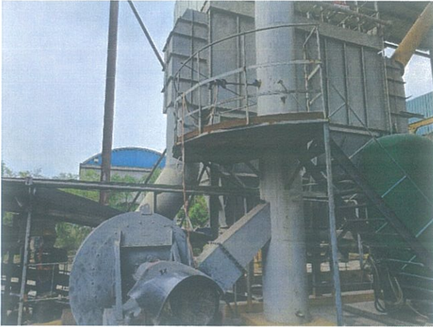
石灰石破碎机排放口（DA001）
