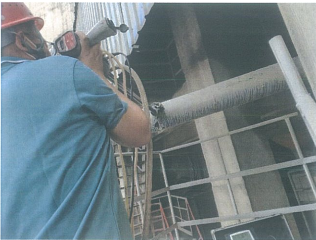
配粉 4#库底废气排放口（DA027）
