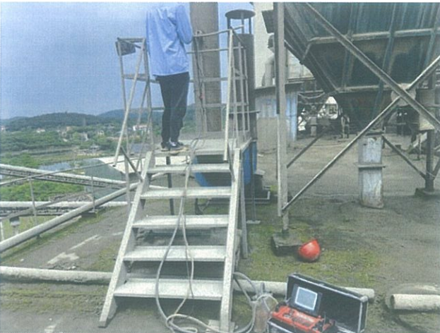
3#水泥原料仓顶排放口 (DA033)
