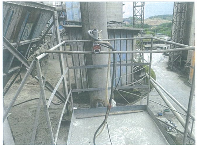
2#水泥原料仓顶排放口 (DA032)
