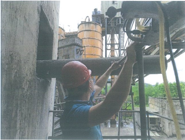
配粉 3#库底废气排放口（DA025）
