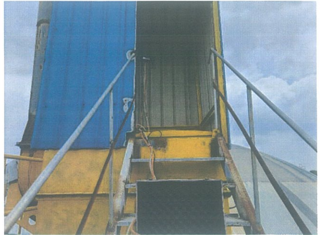
石灰石转运楼排放口（DA002）
