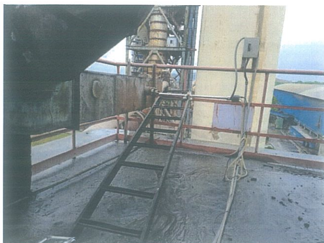
煤粉仓排放口（DA007）
