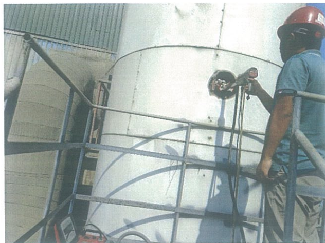
3#水泥磨机尾排放口 (DA040)
