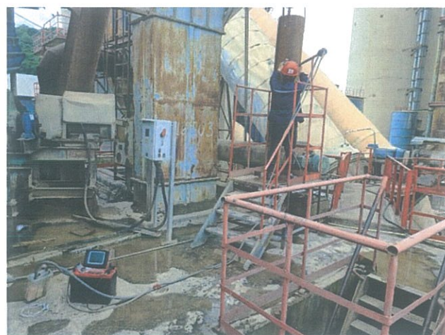
生料磨转运站排放口（DA010）
