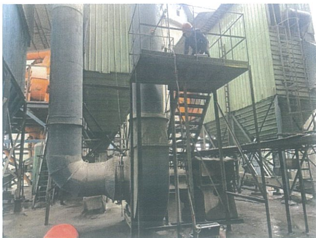
1#水泥磨机尾排放口 (DA037)
